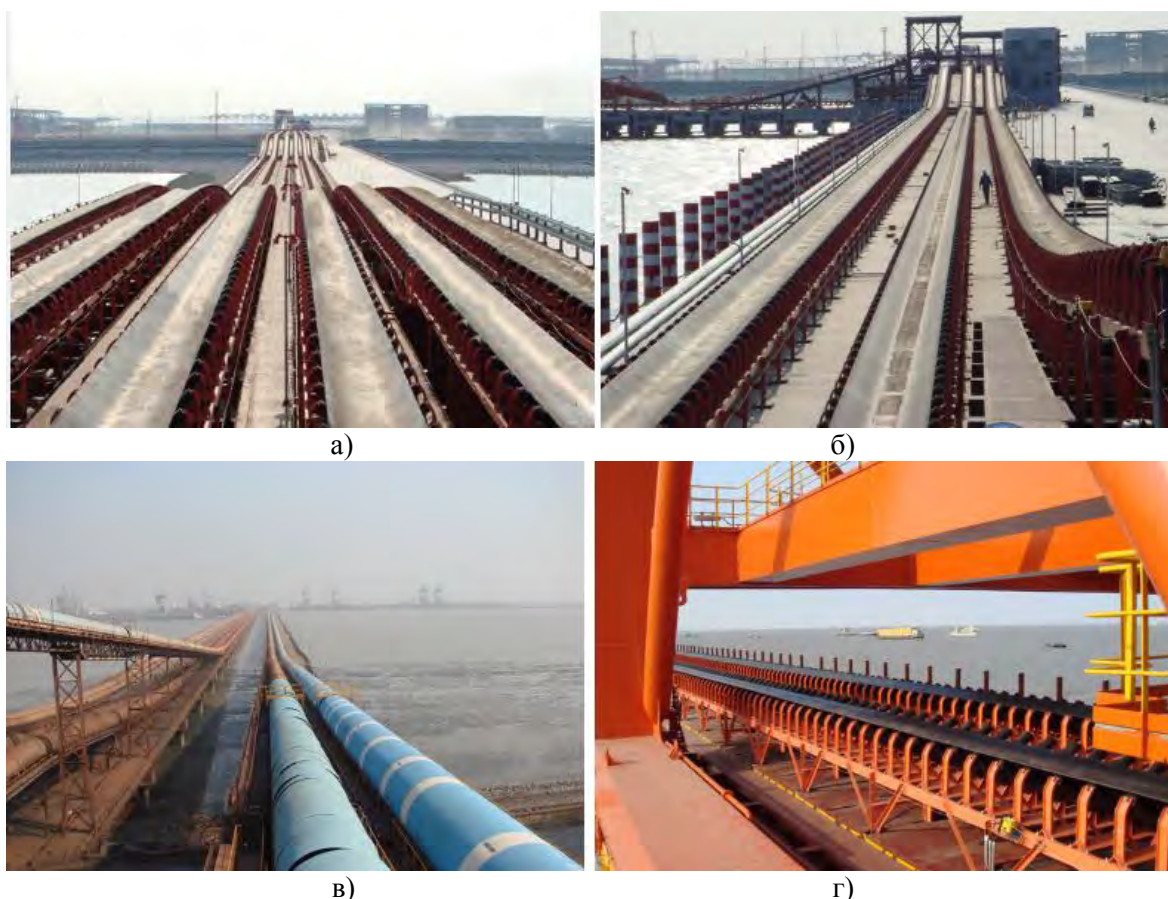
Рис. 2. Панорама портового ленточного конвейера:
